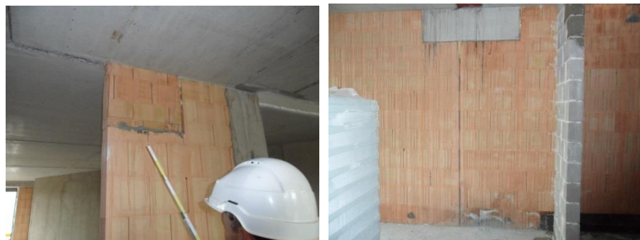
Figuur 7 Ondanks dat het product maar één functie (dragende) opneemt, zal de bouwsnelheid al gevoelig verhogen. Door de lage prefabricatiegraad zijn aanpassingen in-situ nog steeds gemakkelijk te realiseren (Prefabgids PRO 3 , 2017).
