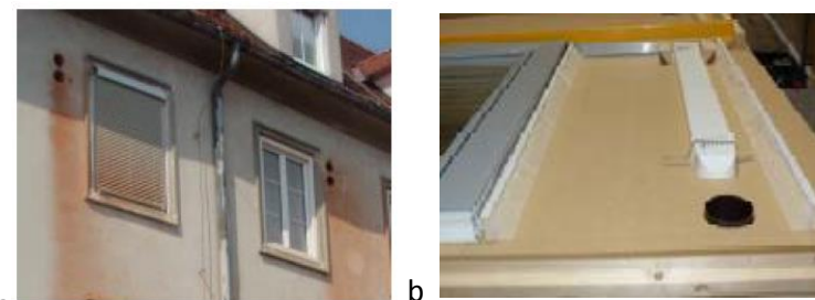
Figuur 16 (a)Gaten in de bestaande gevel voor de aansluiting van de compacte warmtewisselaar.(b) Leiding naast het schrijnwerk in het paneel (TES EnergyFaçade, 2010-2013)
