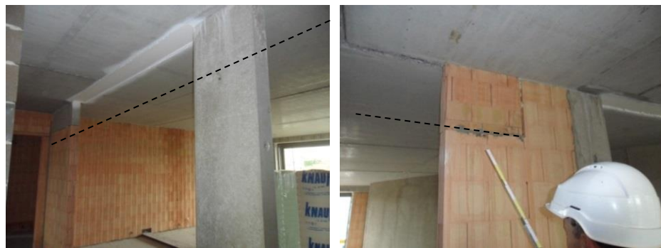
Figuur 13 De uitsparing in de prefab gemetste wand werd opgevuld nadat bleek dat de balk er niet komt
