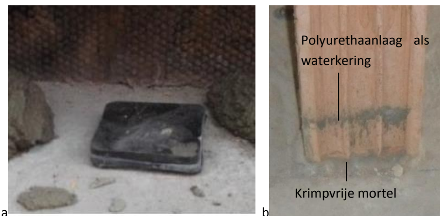
Figuur 8 (a) Stelblokjes tussen de mortellaag (b) Detail onderste rij bakstenen van de wand. PU-laagje als waterkering (Ploegsteert, 2016)
