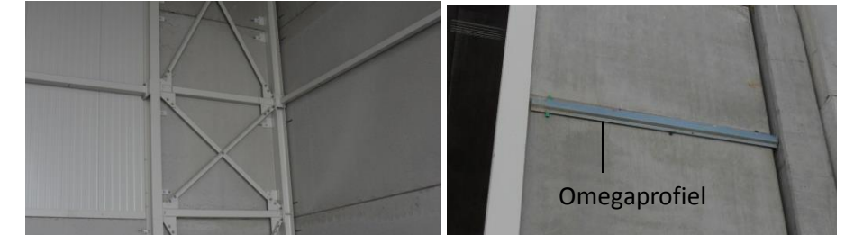
Figuur 68 (a) Doorlopende betonsip als brandmuur (b) Omegaprofiel aan de buitenkant van de betonsip om de sandwichpanelen aan te bevestigen
