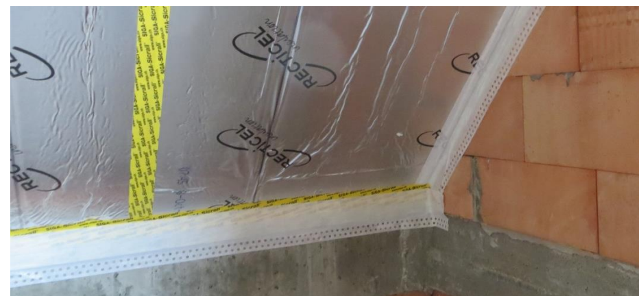
Figuur 17 (a) aansluiting op de binnenmuur met luchtdichte tape. De witte tape is overpleisterbaar
