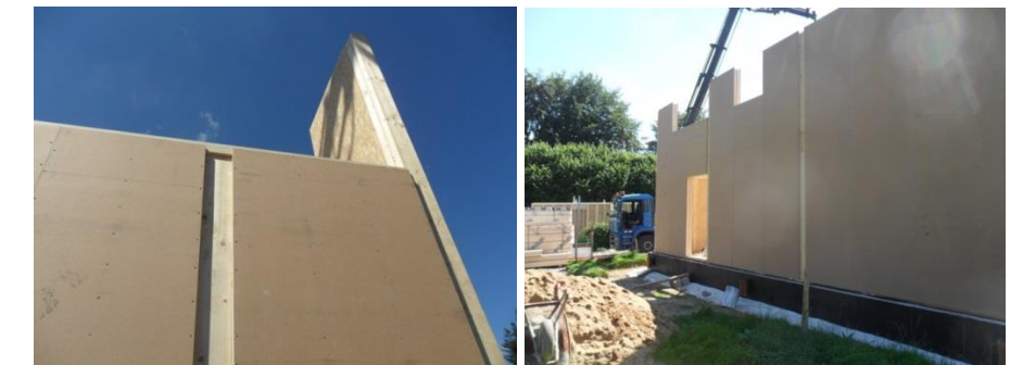
Figuur 31 Holtes ter hoogte van de gelamineerde houten kolommen die later nog worden opgevuld
