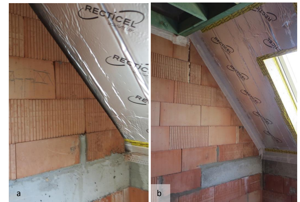
Figuur 19 (a) Scheidende wand tussen kamers binnen één woning (b) woningscheidende wand: opvulling met minerale wol en afdichting met bepleisterbare luchtdichtingstape
