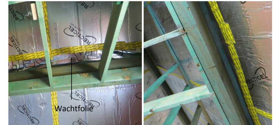
Figuur 18 (a) Wachtfolie aan de gording (b) Aan de onderkant van de gording is ook een tape voorzien
