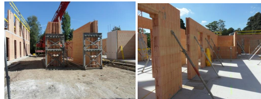
Figuur 7 (a) Stockage prefab metselwerk wanden (b) Onderschoring prefabelement tijdens uitharden mortel
