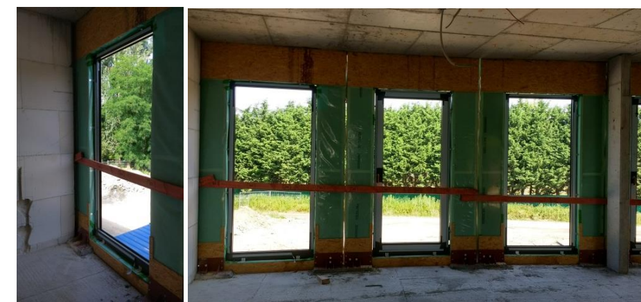
Figuur 54 De voegen zijn bereikbaar om ze in-situ te dichten
