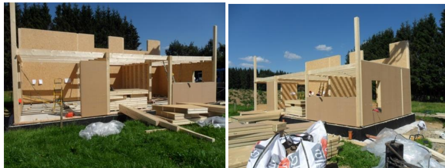
Figuur 26 Aanzicht van de woning op dag 2 sinds de start van de montage op de funderingsplaat
