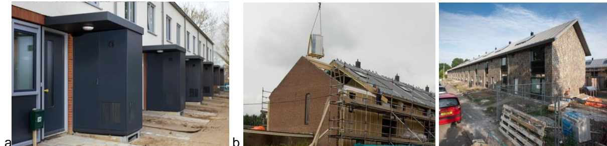
Figuur 3 (a) Energiemodule van Nathan met Hr-ketel en tellers voor water en elektriciteit (Nathan, 2016) (b) Compacte HVAC-unit met de opwekkingstoestellen in Kerkrade (Thermod Brink, 2017)
