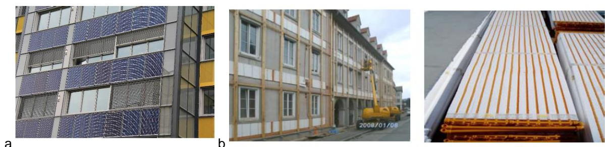
Figuur 8 Prefabrenovatie van appartementsgebouwen in Graz (a) Zonnecollectoren in het gevelement om sanitair warm water op te wekken (b) Koperen warm water buizen , geïntegreerd in een XPS-laag in de adaptielaag.
