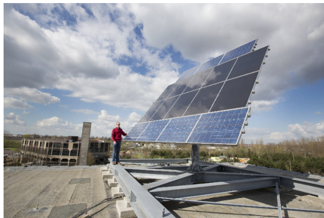
Figuur 2.4: PV-panelen geïnstalleerd op tracker
