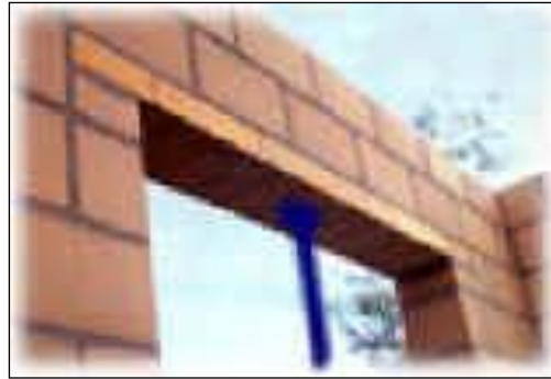
4. Dadelijk verder metselen op de vooraf natgemaakte latei. De verticale voegen moeten goed gevuld worden.
